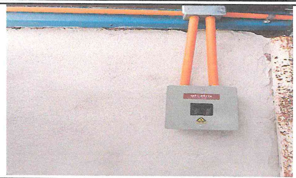
Foto 2: sistema eléctrico HABILITADO Y funcional.
